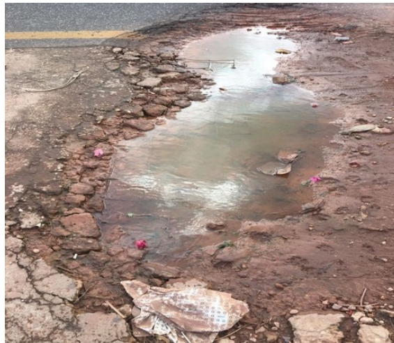
Figura 1: Pavimento com manifestação patológica.
